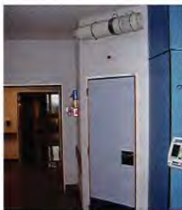
Aspra, luchtreiniger als losstaande unit.
