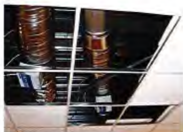
Virus Free Air luchtzuiveringssysteem geïntegreerd in het luchtbehandelingsysteem.
